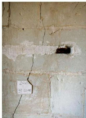
Dans l'aile François 1 er du château de Chambord, des murs fissurés, des fenêtres étayées et une opération de dépôt de tommettes avant le sondage du plancher. VALENTIN PACAUT / CHÂTEAU DE CHAMBORD - LEONARD DE SERRES / CHÂTEAU DE CHAMBORD
