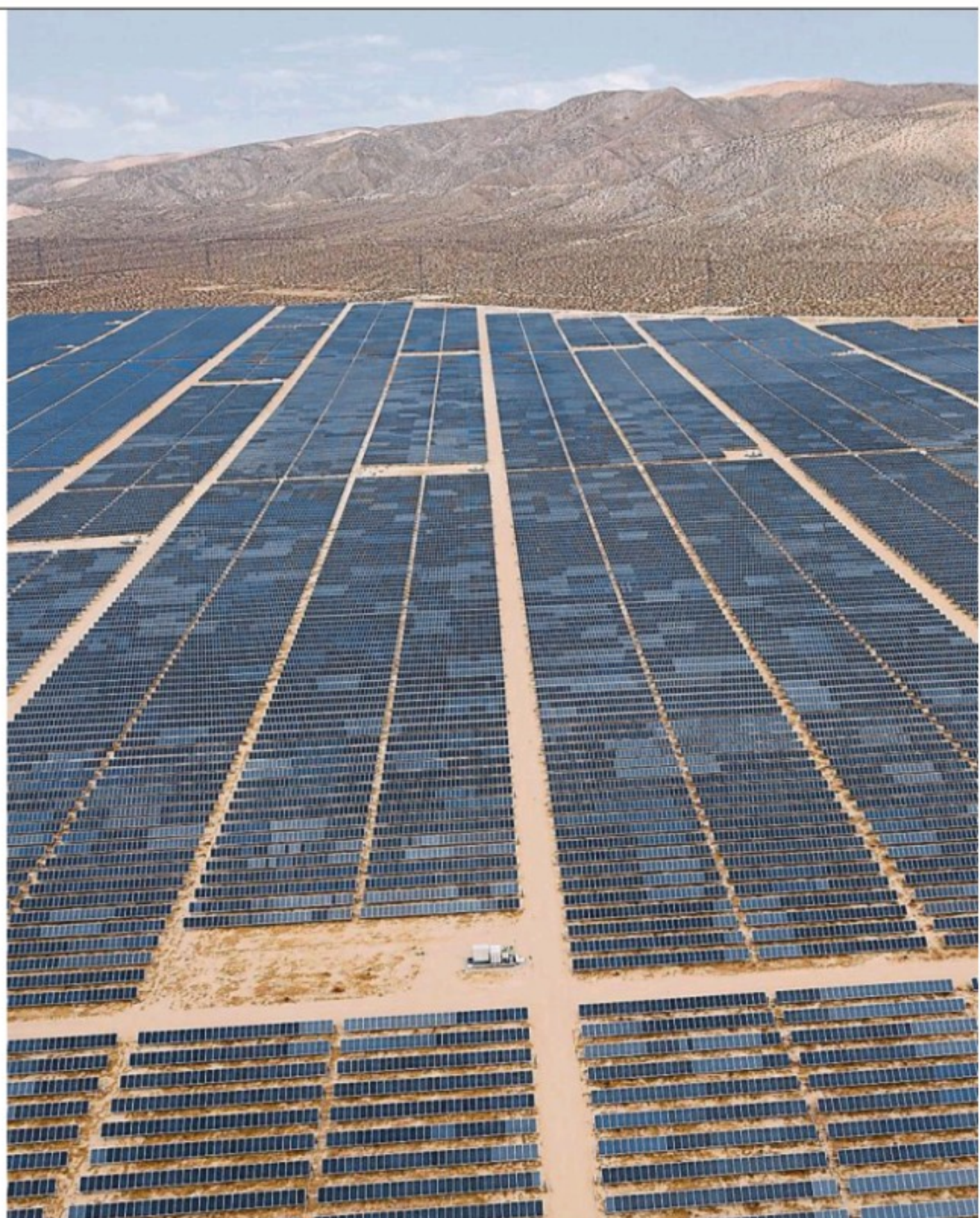
Des panneaux solaires dans le comté de Kern, en Californie. Le projet « Lafayette » de cession des activités d'énergies renouvelables d'EDF en Amérique du Nord pourrait aboutir prochainement.
